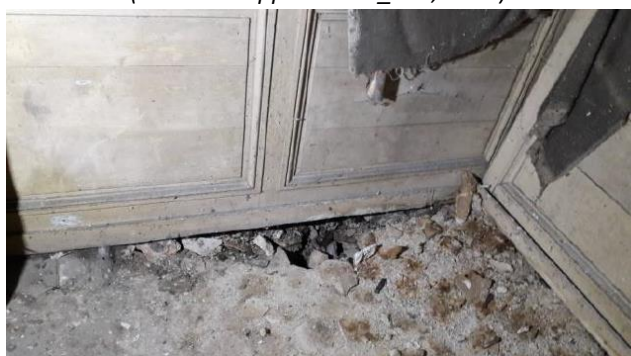
Effondrement du plancher d'une chambre du 2 ème étage sous l'effet du Polypore des caves (Source : Rapport EA17_015, 2017)
