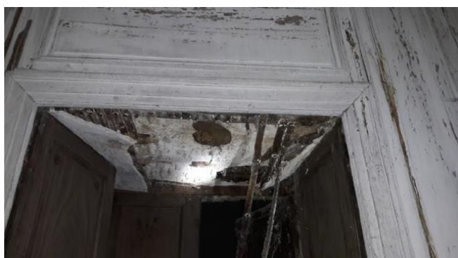
Sporophore de Polypore des caves sur un linteau de porte au rez-de-chaussée (Source : Rapport EA17_015, 2017)
