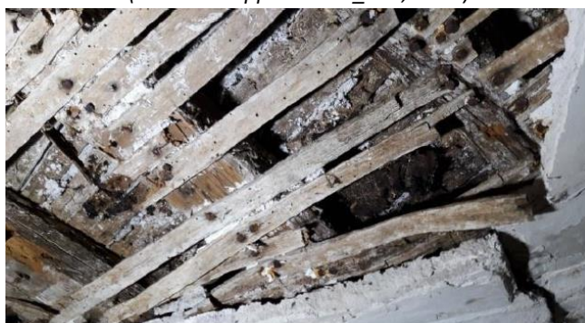
Mérule sur le plafond du 2 ème étage de la tour sud-est (Source : Rapport EA17_015, 2017)
