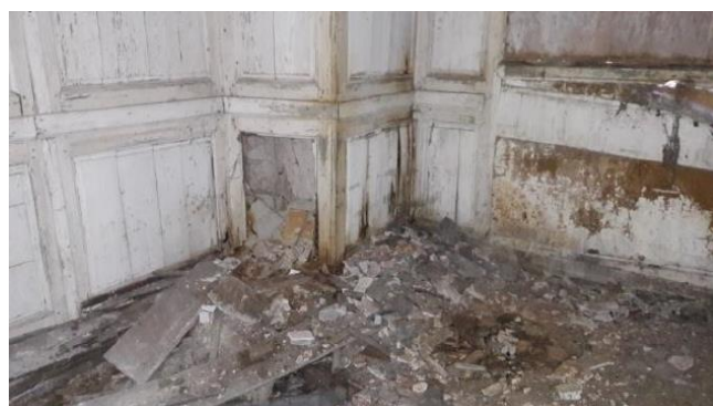
Boiseries et plancher habitées par la mérule et le Polypore des caves au 1 ère étage (Source : Rapport EA17_015, 2017)
