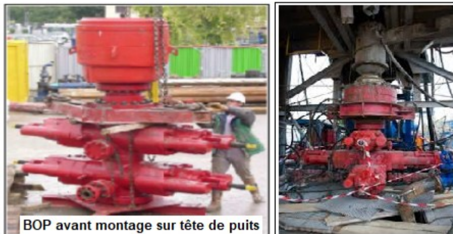
Illustration 10: Obturateur de puits - Source Compagnie Française de Géothermie
