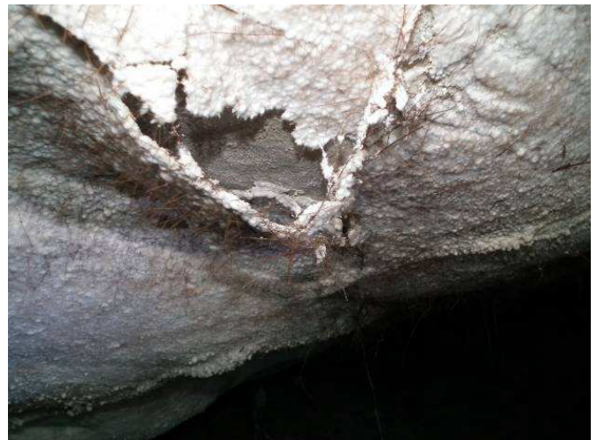
Champignon au toit de la carrière
