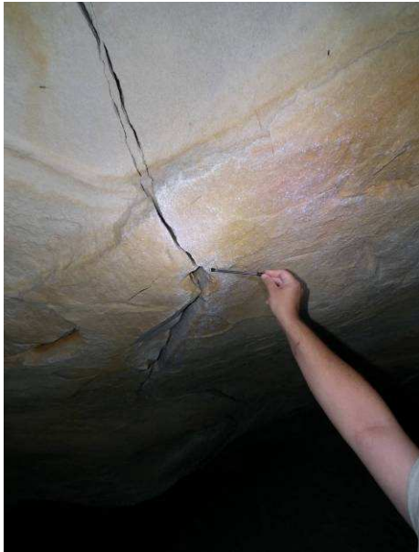
Fissure mécanique au toit
