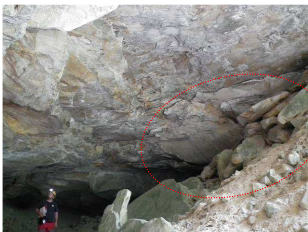
Pierres et blocs instables
