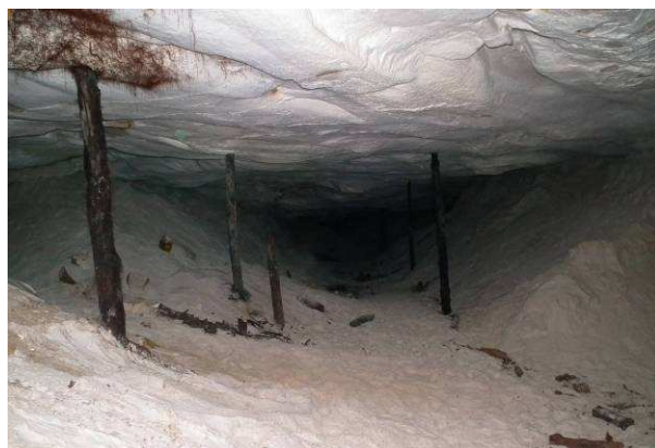
Poteaux au niveau d'une zone fissurée
