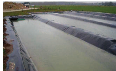
Photo 54 : Bassin de décantation en chicane (Source : SYSTRA, 2012)
