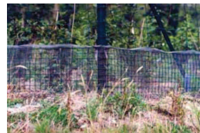
Photo 79 : Treillis petite faune de maille adossé à la clôture « classique ». La partie supérieure est recourbée pour empêcher les animaux d'escalader et la partie inférieure est brochée au sol ou légèrement enterrés (Source : J. Carsignol)
