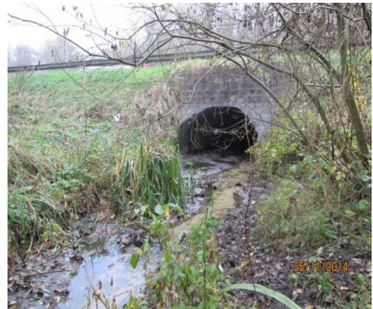
Figure 4 : Tunnel d'écoulement entre le Bois de Brou et le Bois de Vaires (Photos © AEV, 2014)
