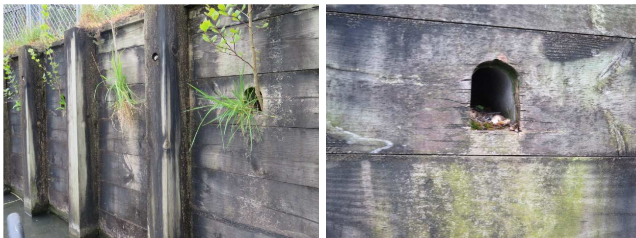
Une vingtaine de cavités artificielles ont été creusées dans les palplanches de la berge sud de l'étang de Savigny sans succès apparent.
