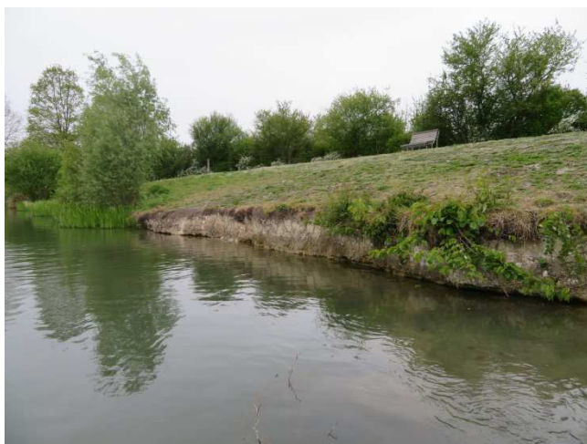
Berges abruptes à faible hauteur directement accessibles au public
