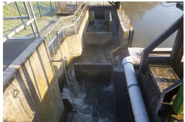
Vue partie amont passe à poissons montaison
