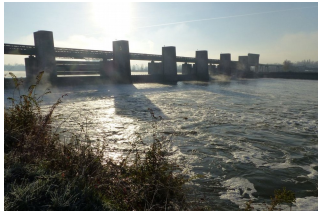
Vue des vannes de décharge
