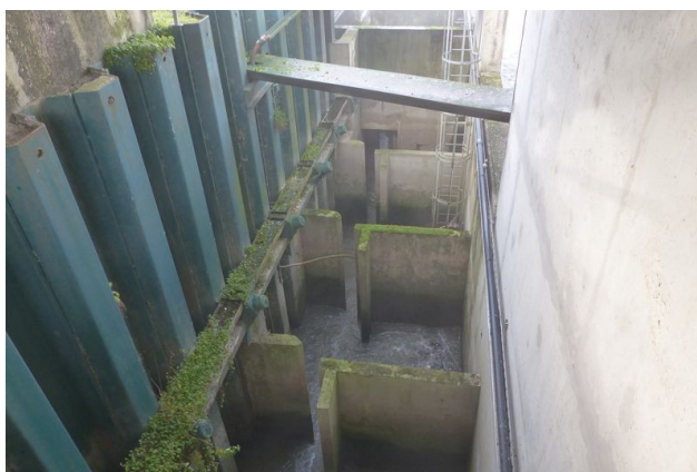
Vue aval de la passe à poissons à montaison
