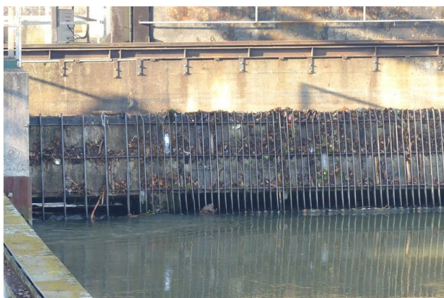
Zoom sur la grille de la prise d'eau au niveau de l'exutoire de dévalaison rive gauche
