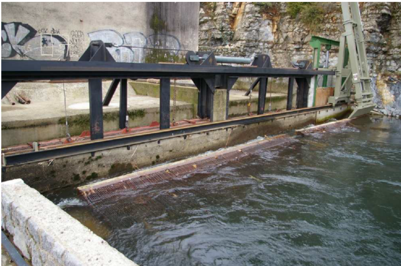
Photo de prises d'eau ichtyocompatible pour la dévalaison sur la Risle (source : D Courret, ONEMA)
