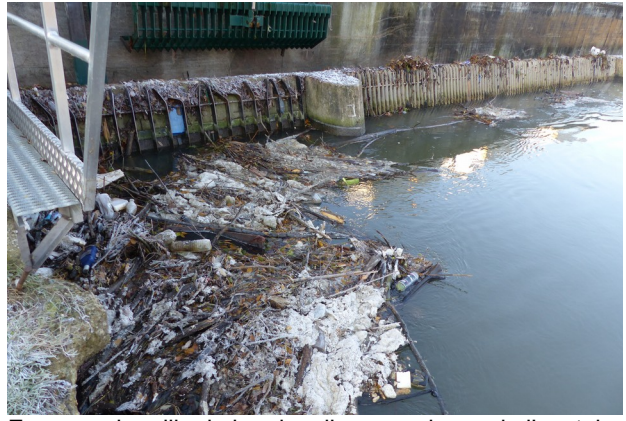
Zoom sur la grille de la prise d'eau au niveau de l'exutoire de dévalaison
