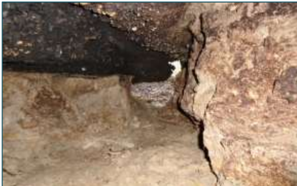
Cavité créée par l'érosion hydraulique
