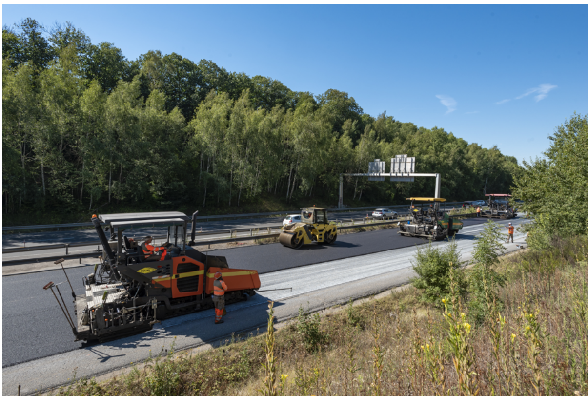
Travaux/Création d'une nouvelle voie dédiée aux bus sur la RN118 | Crédit photo : Alexandre Heise
