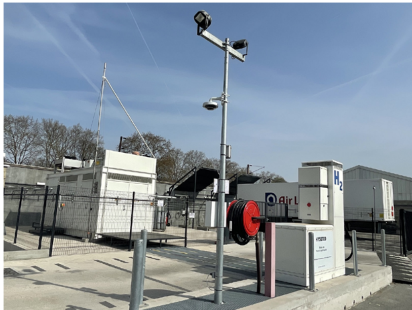
Station de distribution d'hydrogène-Porte de la Chapelle (93) | Crédit photo : Hysetco
