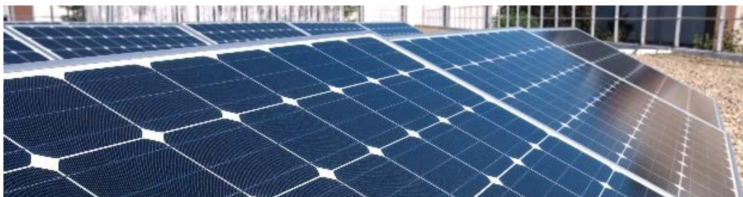
Panneaux solaires photovoltaïques (75) | Crédit photo : DRIEAT
