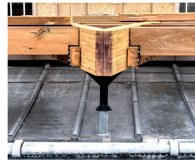
Des potelets métalliques permettent l'horizontalité du plancher bois. Ils portent sur la structure, non sur la toiture. Des trous doivent être percés dans le zinc pour les fixer.
