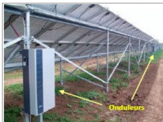
Figure 6 : Exemple d'onduleurs décentralisés (Source : étude d'impact)
