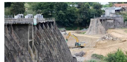
Figure 10 : Barrage de Vezins avant et pendant sa déconstruction (OFB, La Manche Libre)
