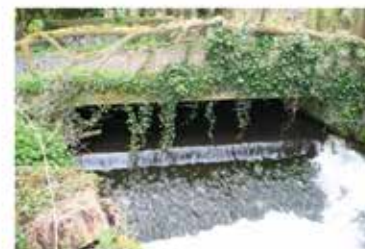
Seuil, avant travaux, infranchissable à l'étiage
