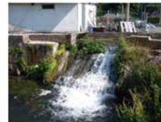
Chute avant travaux
