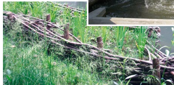
Passes à poissons à Creil, dans l'Oise
