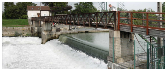
photographie n°1 - Barrage sur le bras droit de la Marne
