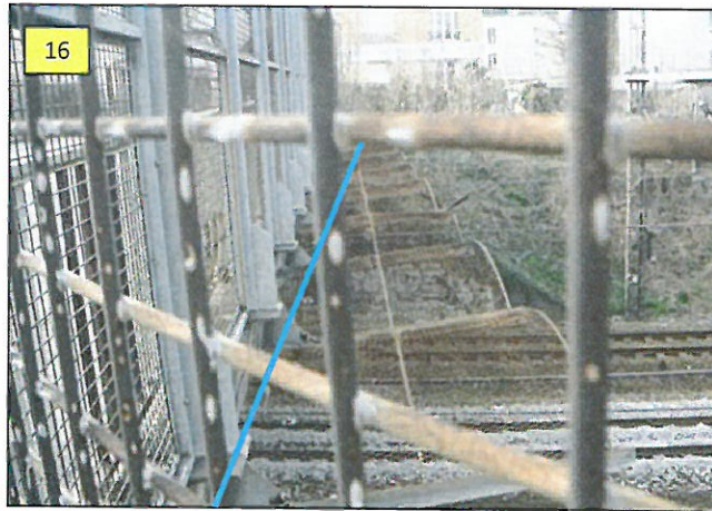
16 Franchissement voie SNCF Pont rue des Berthauds : Passage en encorbellement conduite calorifugée sur le tablier
