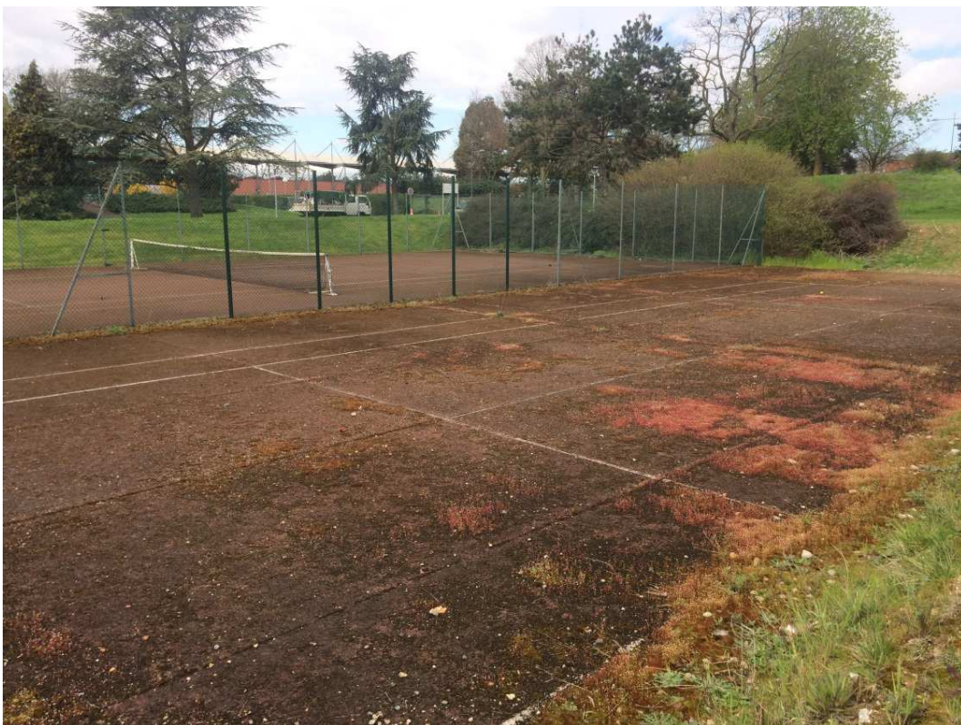
Photographie 10 : Vue des cours de tennis non entretenus (3)
