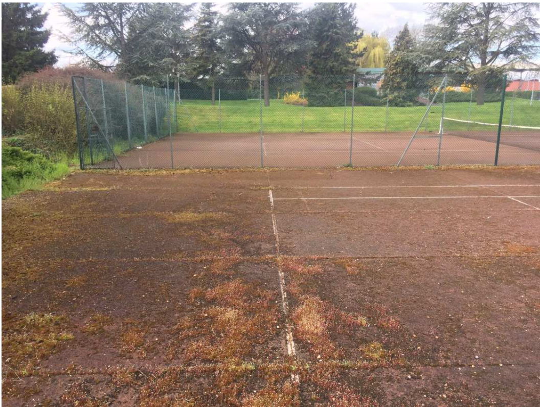
Photographie 9 : Vue des cours de tennis non entretenus (2)
