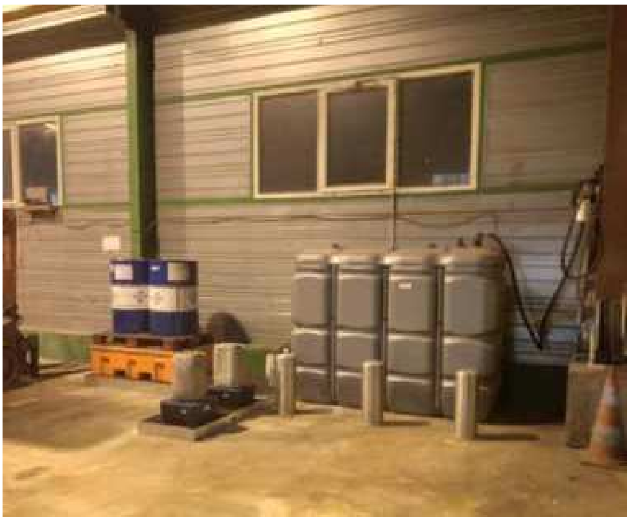
Cuve de stockage de GNR (2 m 3 ) et de produits de maintenance
