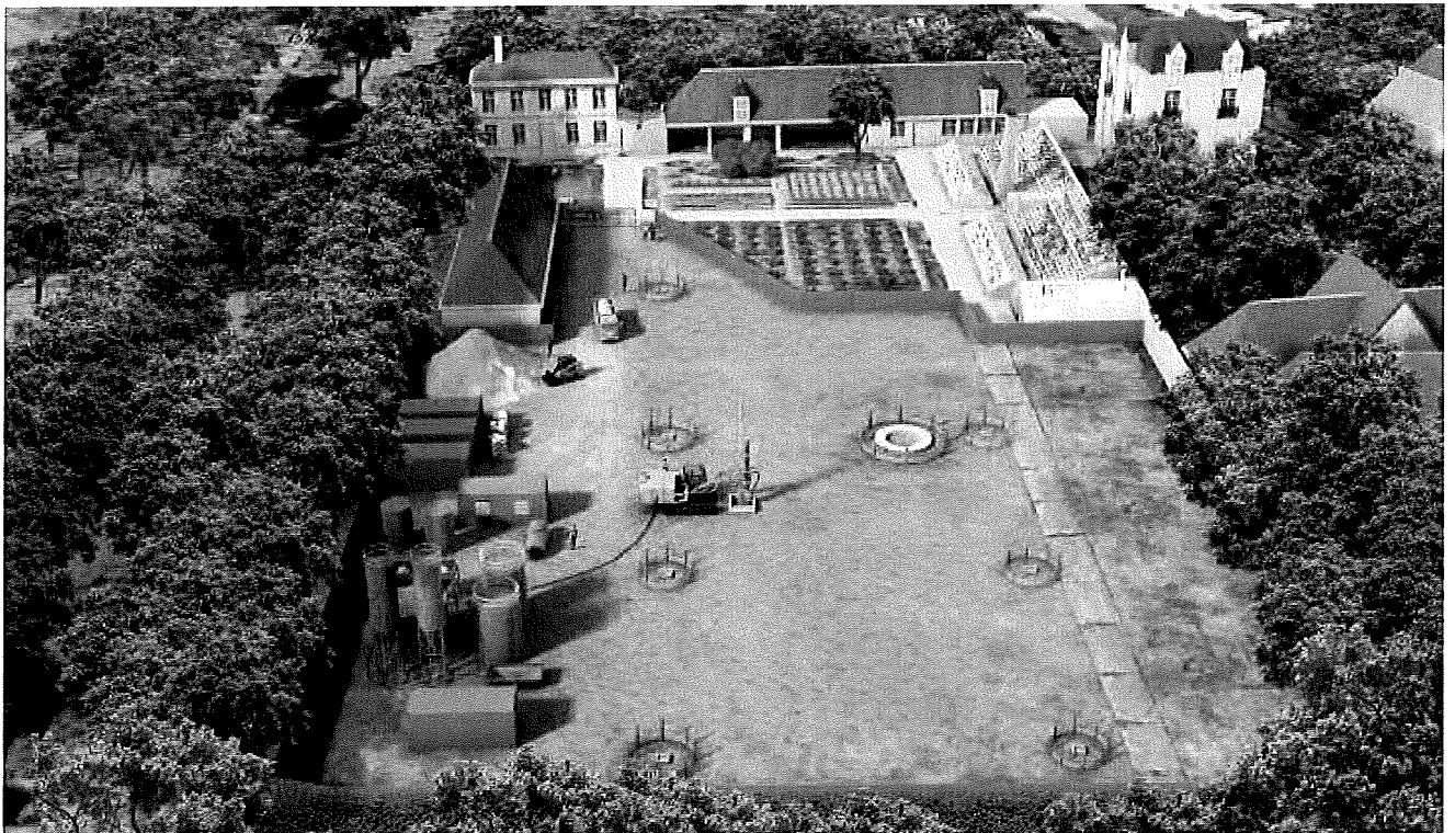
Vu des travaux avec la mise en défens des sites de reproduction de l'Alyte accoucheur (source : SES, 2018)
