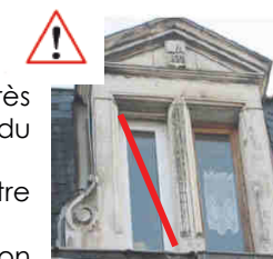
Alourdissement du dessin de la menuiserie et diminution du clair de jour avec la pose en rénovation
