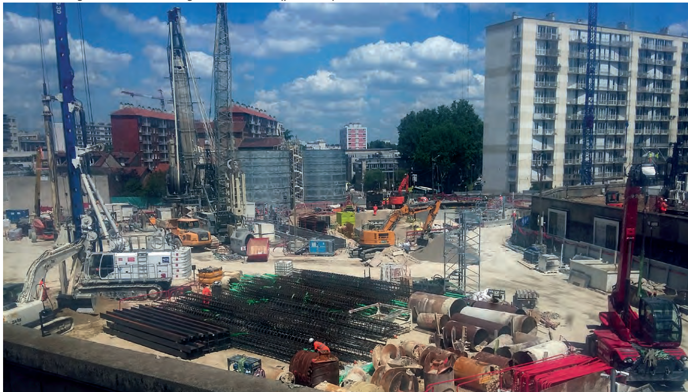
Chantier de la gare du métro de la ligne 15 à Chatillon (juin 2019)
