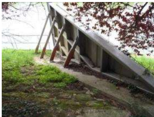
Figure 5 : Déflecteur et support (Source : rapport PRO de l'étude « Neuilly inondation »)
