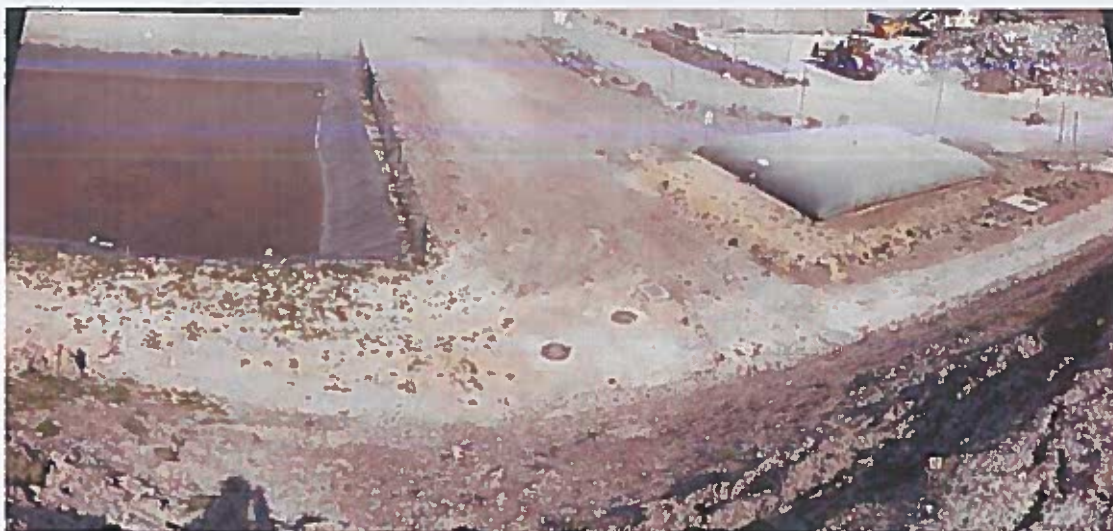
Zone plateforme traitement des DAE de chantiers, bâche à eau et bassin EP
