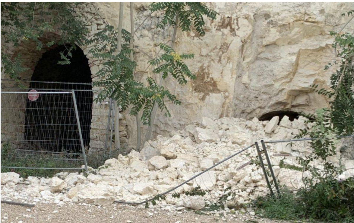
Effondrement de la falaise à proximité de la carrière Saint Nicolas à Montereau – 30/082022 Image issue de actu.fr
