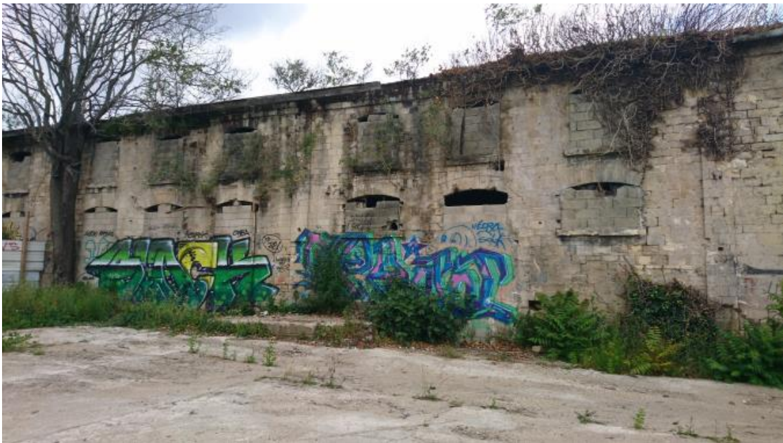
Figure 16 : Bâtiment à l’abandon avec dalle béton
