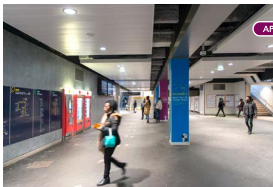
Le pôle d'échanges de Juvisy-sur-Orge, la salle d'échanges et le souterrain central en cours de réhabilitation (nov.2019)
