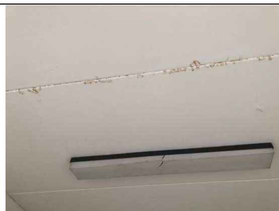
Traces d'égouttures au plafond
