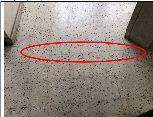
Fissure sur le carrelage
