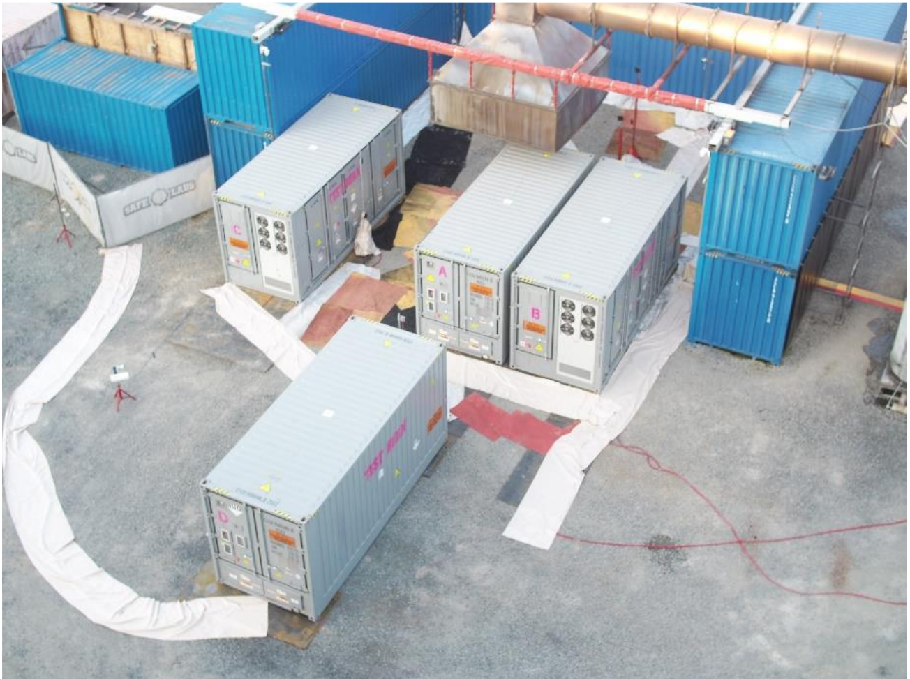
Configuration du test avec les quatre containers CATL EnerC+
