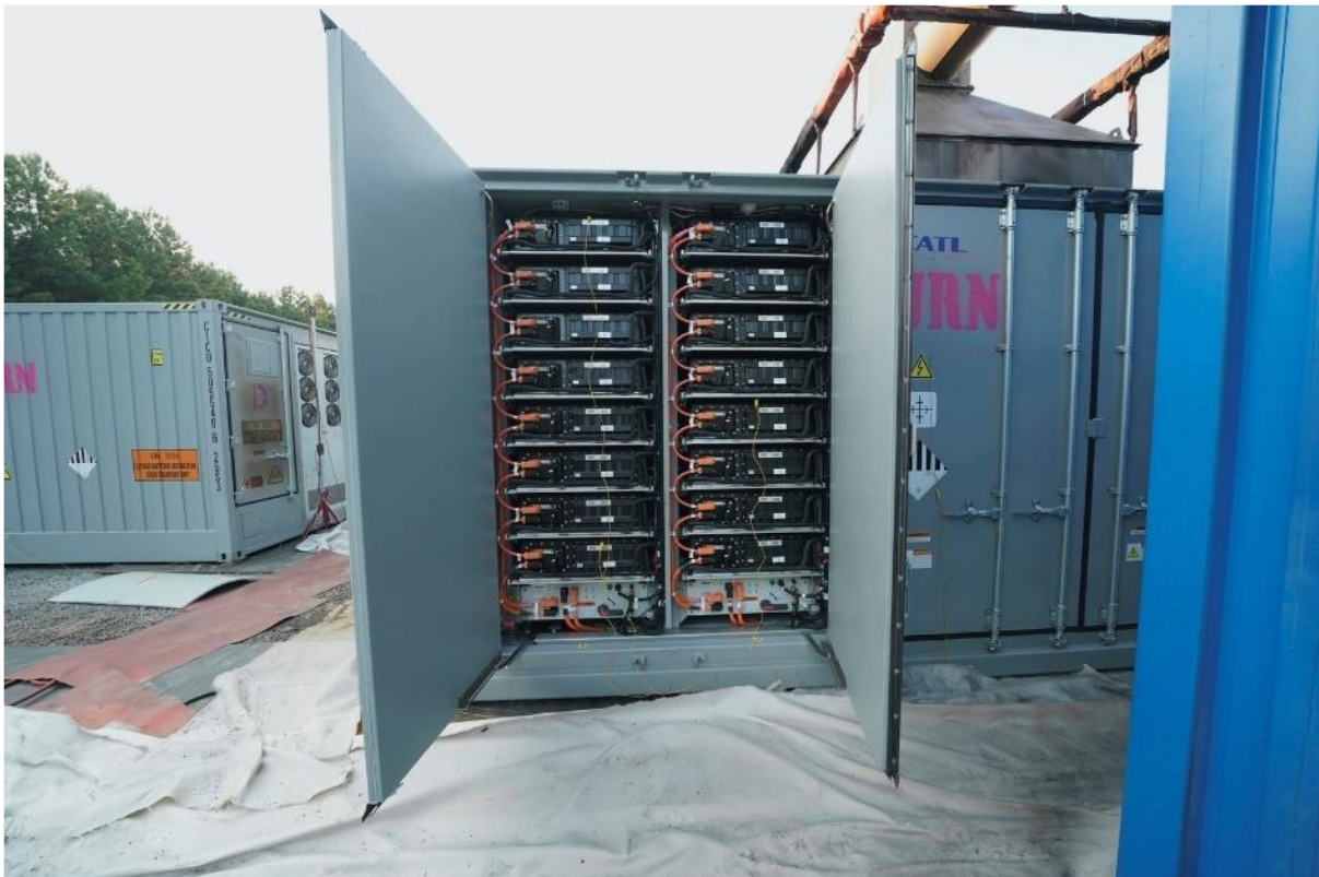
Intérieur de la batterie B (située à 0,20 mètres de la batterie A incendiée), après le test – Modules intacts
