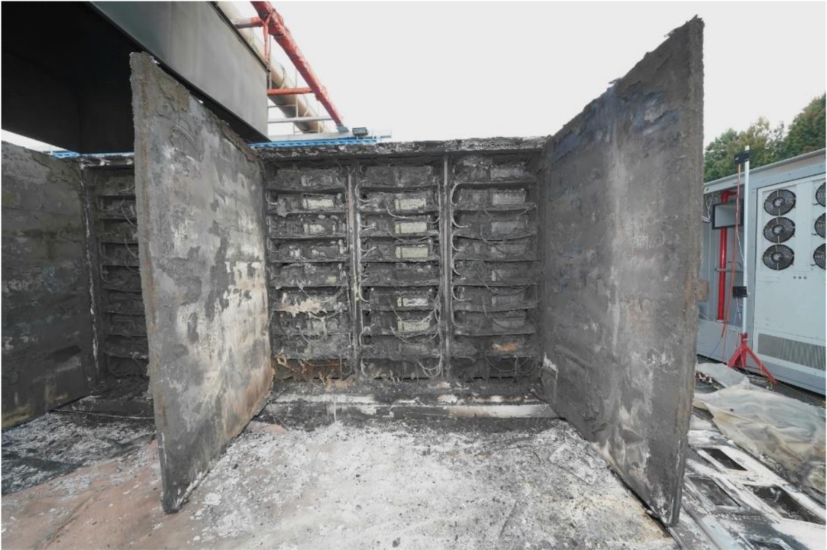
Intérieur de la batterie A, volontairement incendiée, après le test – Modules brûlés
