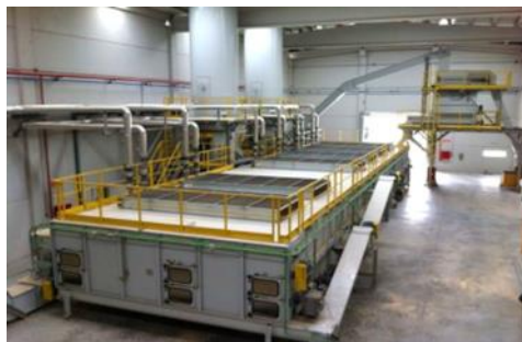
Figure 18: Exemple de sécheur à bande installé à l'intérieur d'un bâtiment
