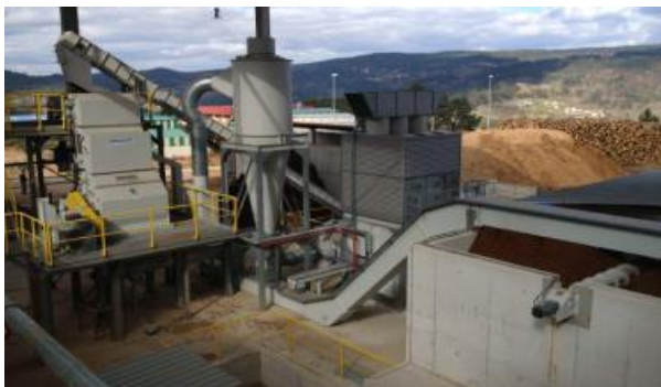
Figure 15: Vue générale de la ligne de broyage humide
