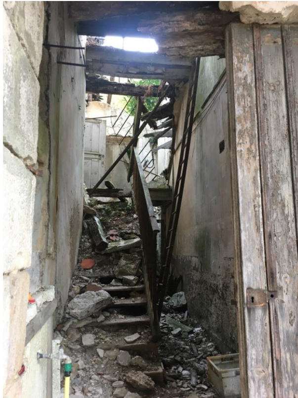
Effondrement en 2019 d'une partie des planchers de l'aile Est, vue sur l'accès au gîte principale actuelle de Murins à oreilles échancrées
