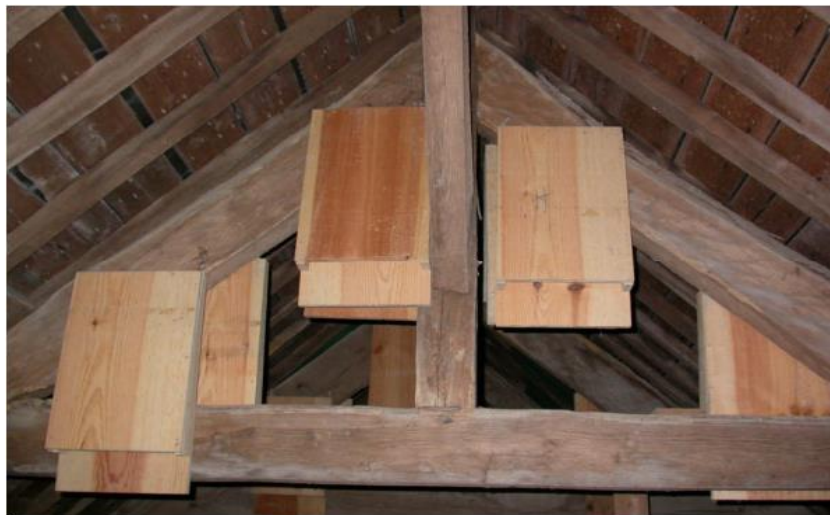
Figure 62. Exemple d'installation de gîtes en bois dans un comble
