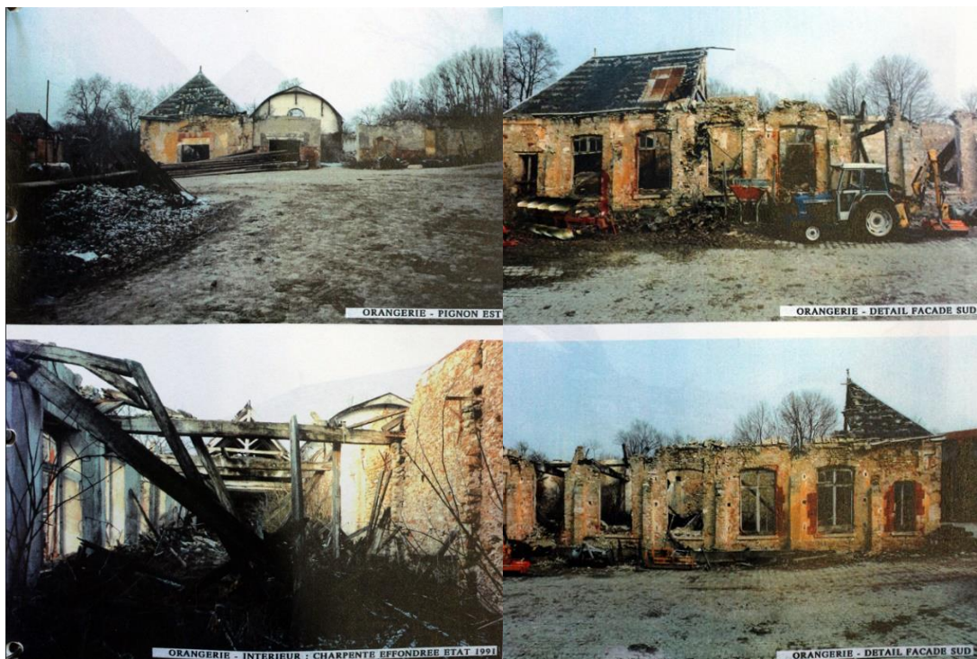
Etat de dégradation en 1991
