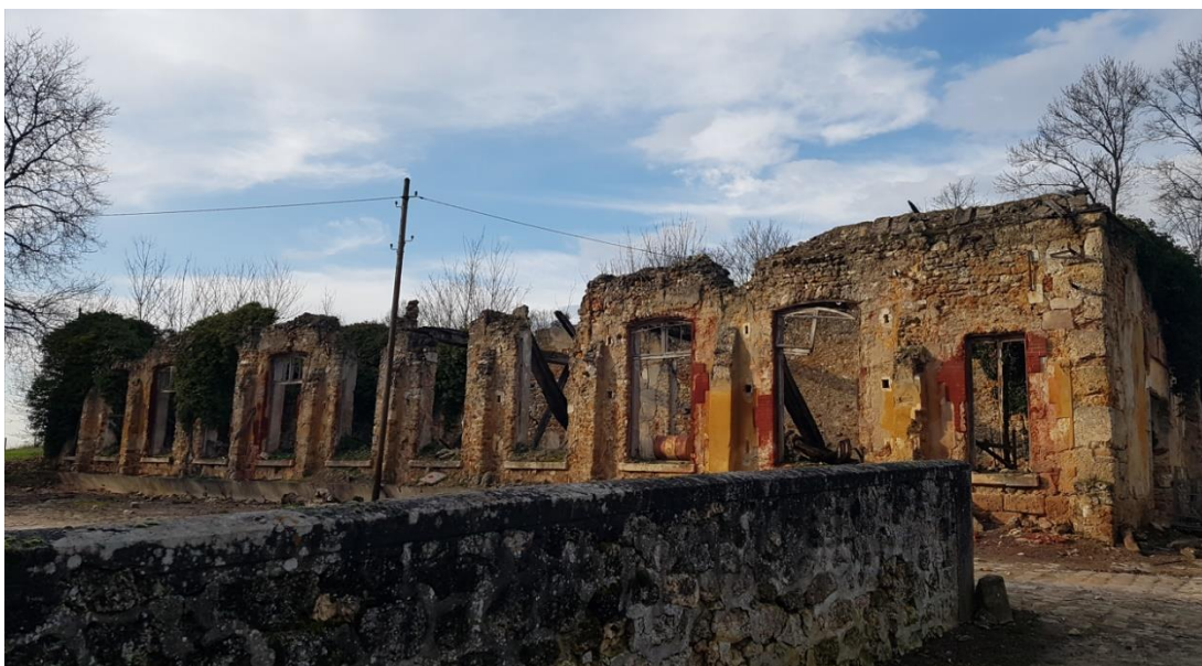
Etat de dégradation actuelle
