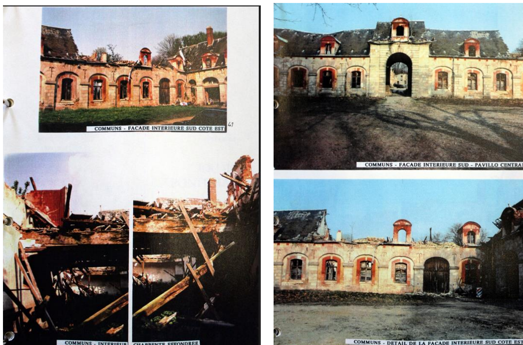
Etat de dégradation, façade intérieure sud coté Est, en 1991
