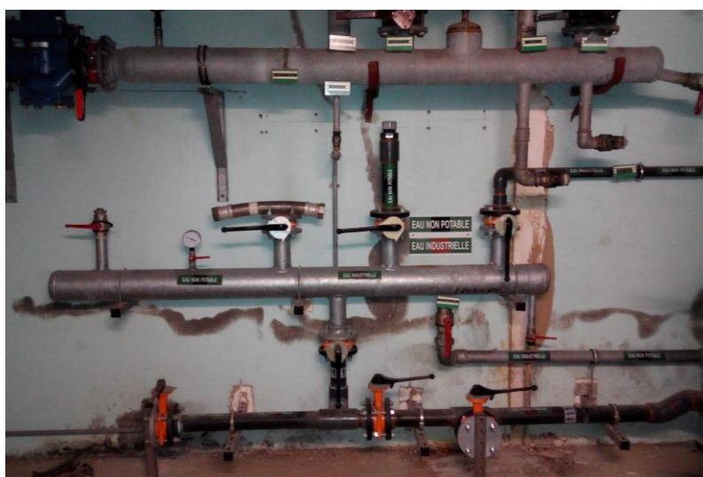
Utilisation d'eau industrielle pour le refroidissement des pompes de la station de relevage VL2 – Département du Val-de-Marne
