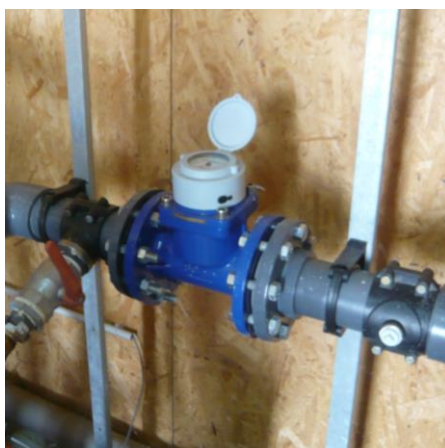
Compteur relevant la consommation d'eau souterraine, au centre de production horticole de la communauté d'agglomération Plaine Centrale
