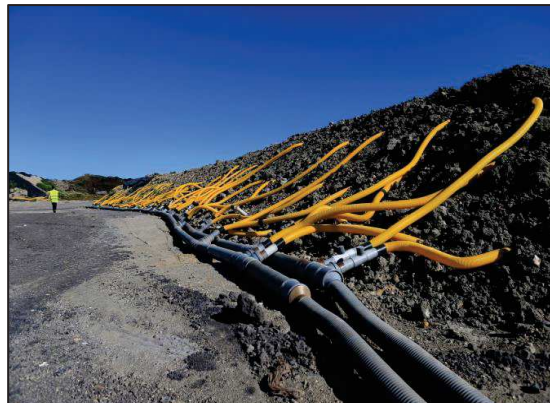
Figure 19 : Double réseau de drains dans les biopiles (avant bache)
