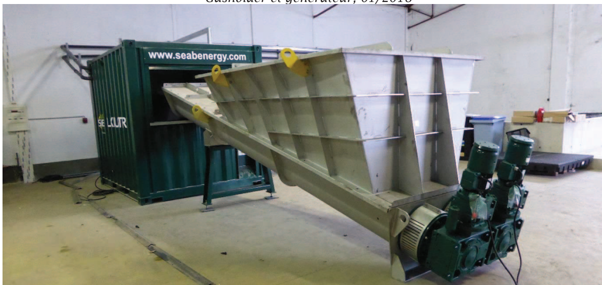
Trémie d'alimentation dans le bâtiment, 01/2018
