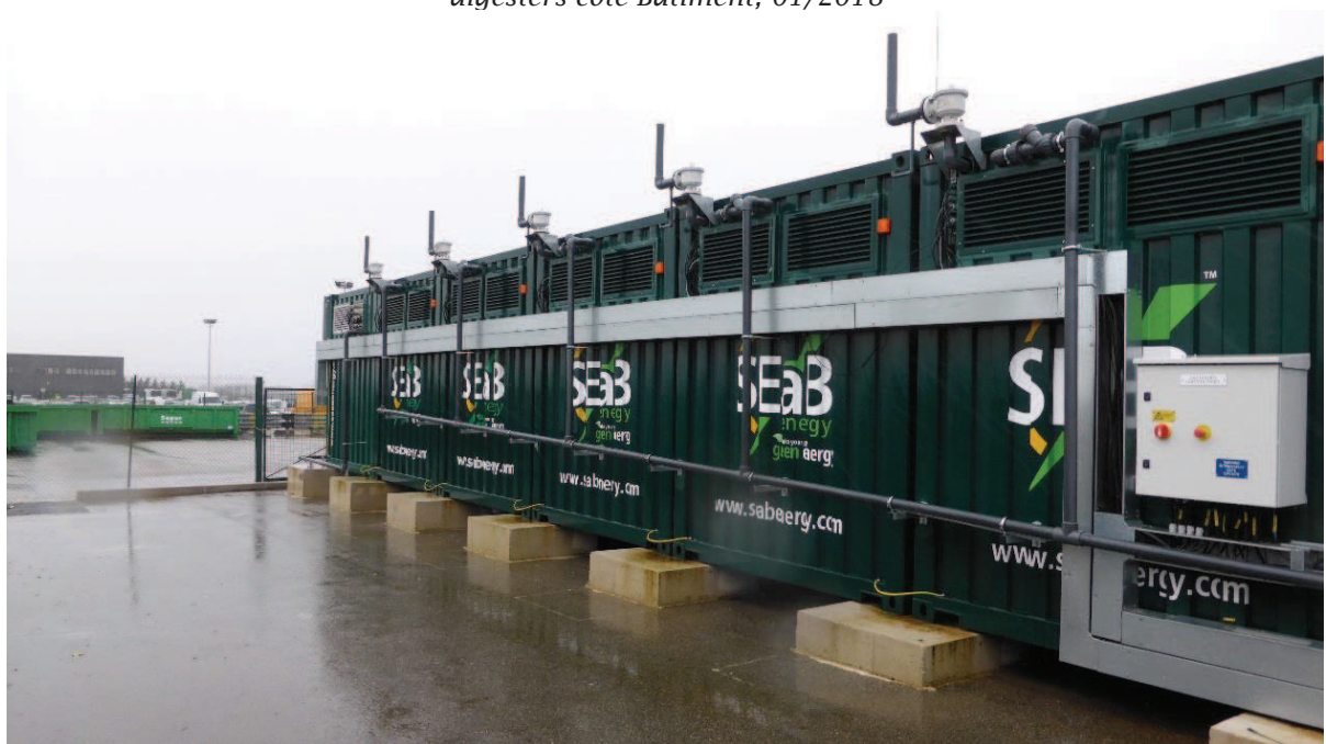
Digesters coté plateforme, 01/2018
