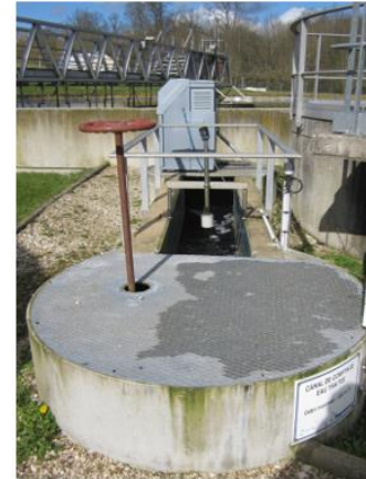
Canal de comptage en sortie du Clarificateur
