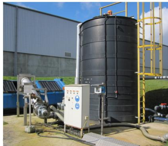
Traitement des graisses (BIOMASTER)
