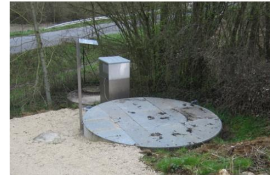
Poste de comptage et prélèvement en sortie de lagune
