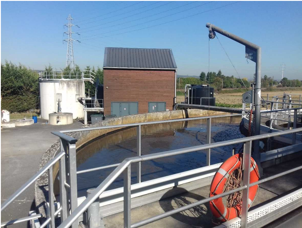
Vue du pré traitement et du bassin biologique
