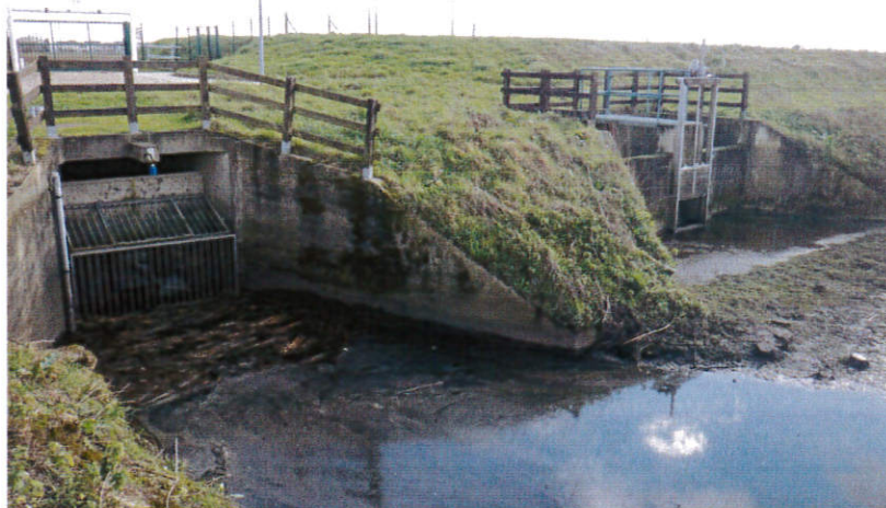
FIGURE 7 : OUVRAGES DE SORTIE DU BASSIN 1 : DO1 A GAUCHE ET DO2 A DROITE
