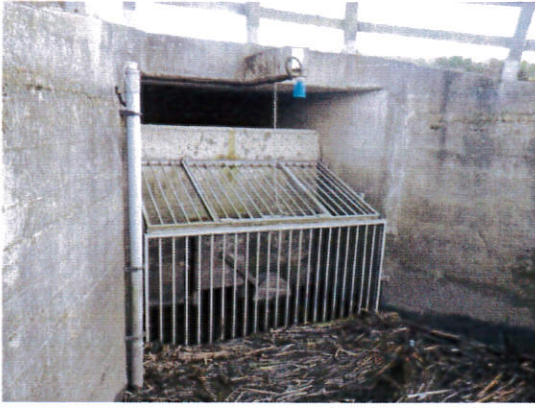
FIGURE 9 : DO1 DU BASSIN 1, AVEC LA VANNE FLOTTANTE LIMITANT LE DEBIT
