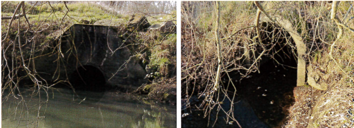
FIGURE 2 : OUVRAGES D'ENTREES DU BASSIN 1 : SORTIES DU DESHUILEUR/DEBOURBEUR A GAUCHE, SORTIE DU BY-PASS A DROITE
