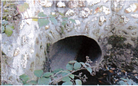
FIGURE 4 : BUSE ASSURANT LA LIAISON ENTRE LE BASSIN 1 ET LE BASSIN 2
