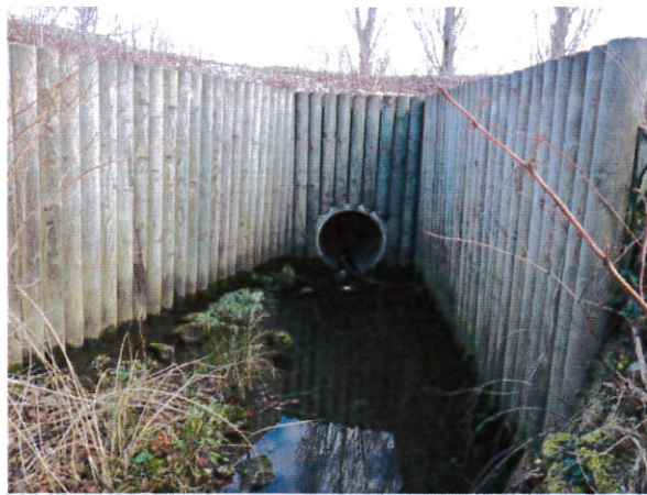
FIGURE 6 : EXUTOIRE DANS LE BASSIN 2
