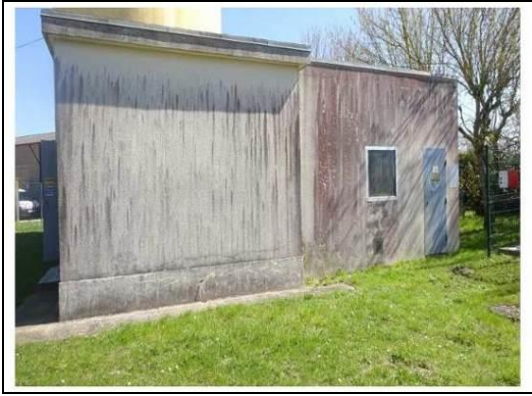
Photo 7 : Local de la station de traitement
