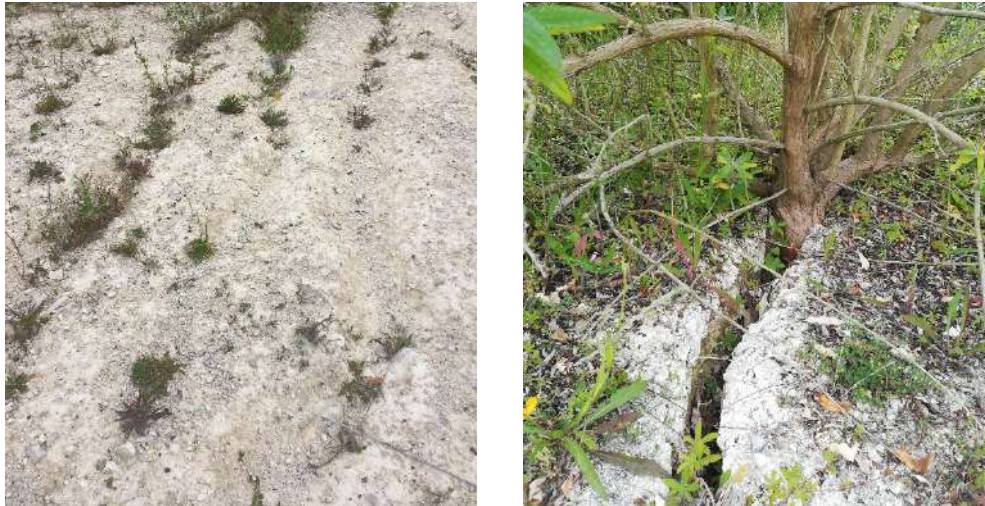
Figure 5 : Photographies de fissures et anciens mouvements de terrain sur l'ancien remblai (Source : GEOS)
