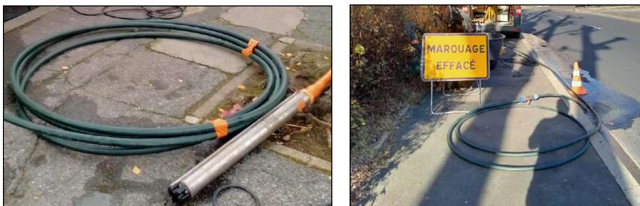
Figure 5 : Système de pompage utilisé
