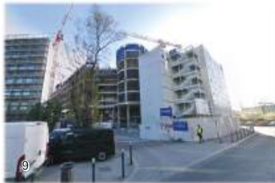
Vue sur un immeuble de bureaux (projet So Pop) en cours de construction à l'angle du Passage Colisée et de la rue Fructidor
