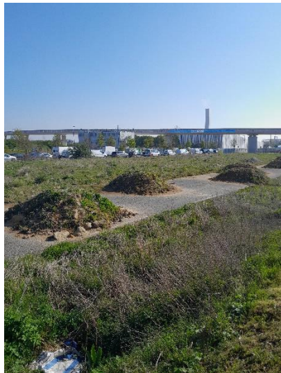
5 : Vue prise depuis le Sud-Ouest du site vers chantier de la ligne 18,
