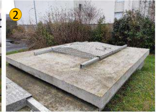
Vue sur la chambre du forage F13 « ADER »
