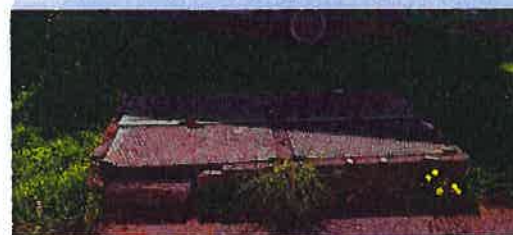
Vue 10 : accès aux cuves de la station-service
