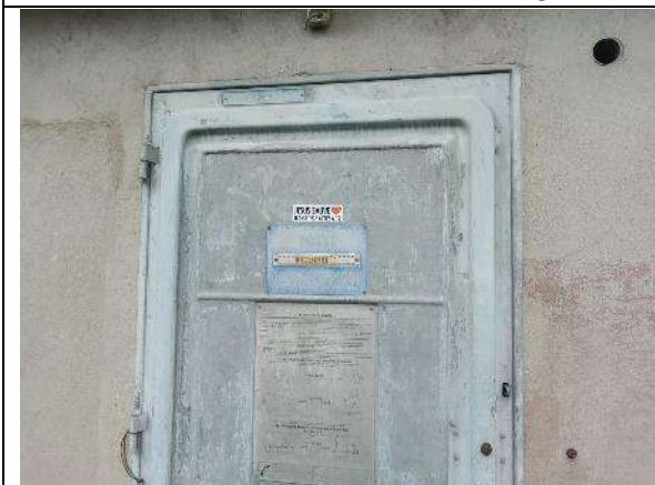
Vue du transformateur électrique
