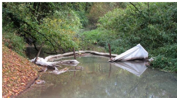
Figure 23 : Exemple de dispositif de barrage anti-MES mis en œuvre (ARTELIA, 2019)
