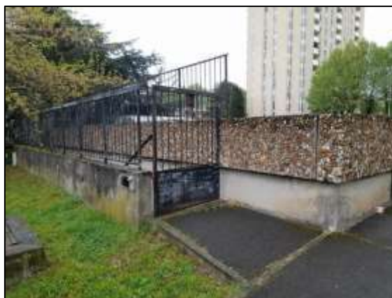
Chaudière à proximité du bâtiment T6
