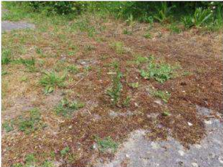
Ancienne voie revêtue colonisée par la végétation
