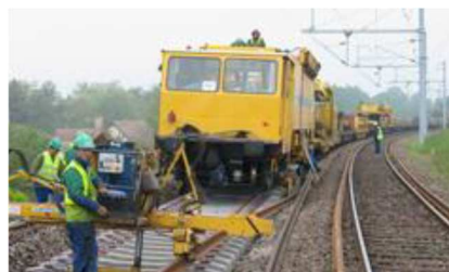
Longs rails soudés sur traverses béton
