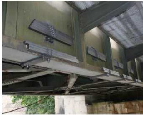
absorbeur sur platelage
