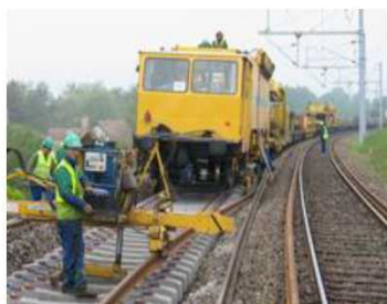
Longs Rails soudés sur traverses béton
